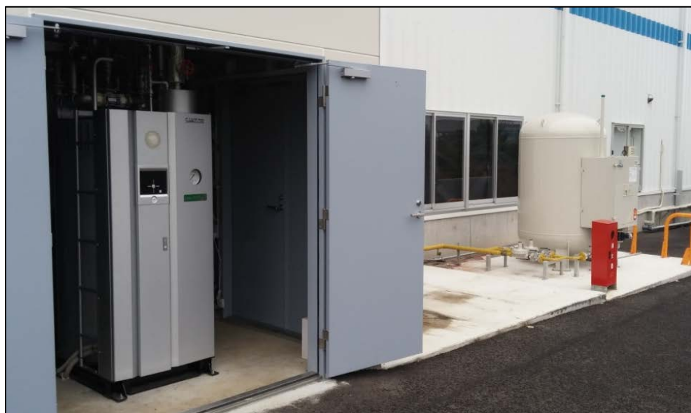
BAiO-50Eと蒸気式簡易ボイラ設置例（茨城県内）
